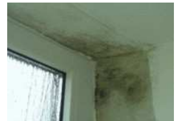
Flächiger Schimmel Innenwand
