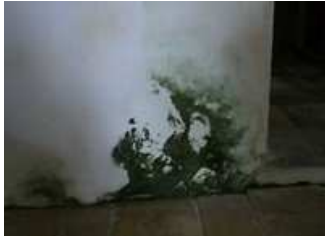
Schimmel an der Aussenwand
